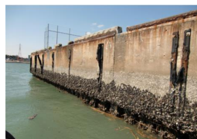
写真 5.2 防衝設備の変状の事例
