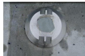
写真 3.1 電位測定端子
