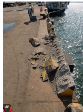
写真 5.3 車止めの変状の事例
