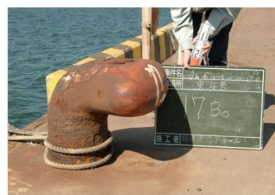
写真 5.1 係船柱の変状の事例
